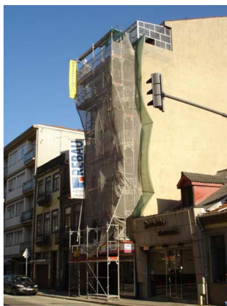
Fig.20 – Colocação de andaimes pode facilitar a ocorrência de furtos
