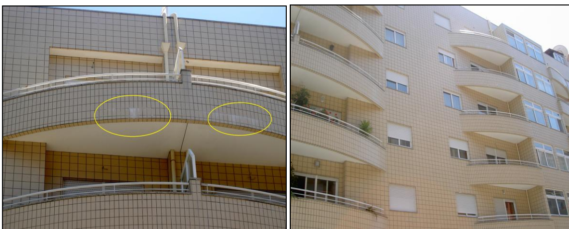
Fig. 47 - Formação de babados. Aspecto geral da fachada.
