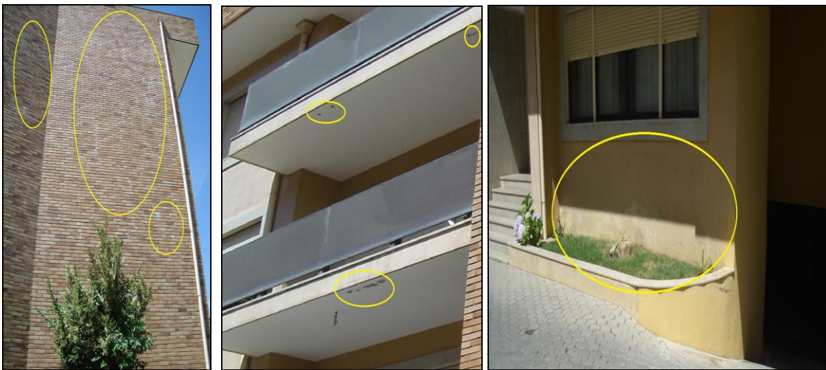
Fig. 30 – Escorrências de coloração Branca. Descasque dos tectos das varandas. Descasque e Degradação do revestimento acima das floreiras
