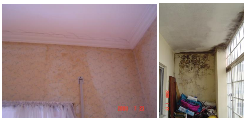
Fig. 59 – Manchas de Humidade em tectos e paredes. Manchas de condensação com formação de fungos.
