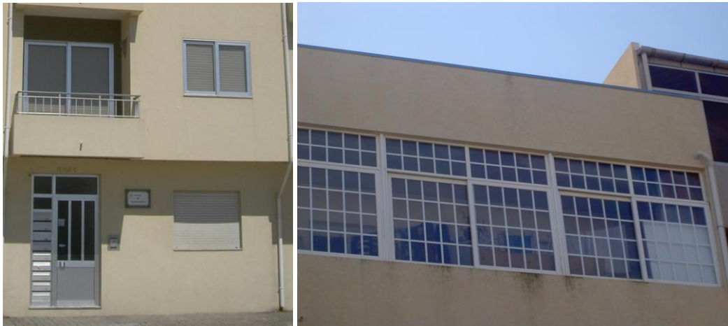
Fig. 60 - Fachada Actual isenta de fissuras manchas. Fachada Posterior com manchas junto às janelas.
