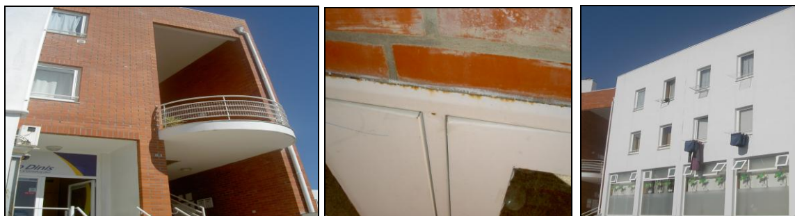
Fig. 44 – Fotografia de uma das fachadas intervencionadas e Porta Metálicas do Gás
