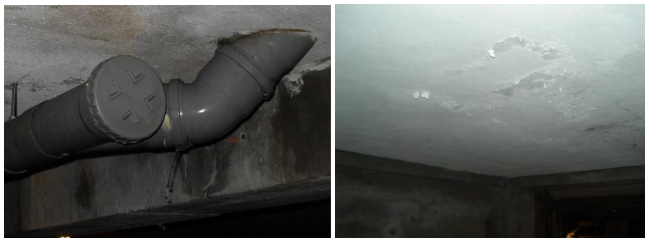
Fig. 56 – Escorrência pelos tubos de saneamento. Descasque de Tinta e Manchas de Humidade em Tectos
