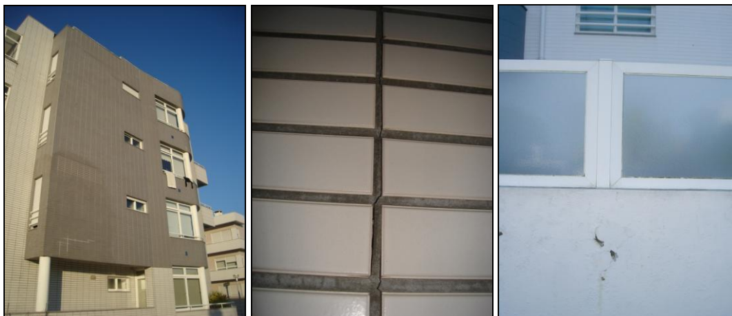
Fig. 49 . Fissuração e mancha de infiltração na fachada. Fissuração da junta de argamassa dos cerâmicos. Descasque de tinta nos muros exteriores.
