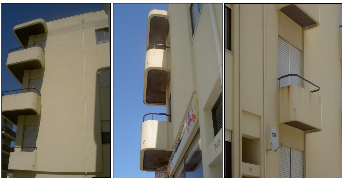
Fig. 35 – Fachada lateral do prédio. Tectos da varanda com manchas de coloração branca. Escorrências de ferrugem nos muretes das varandas.
