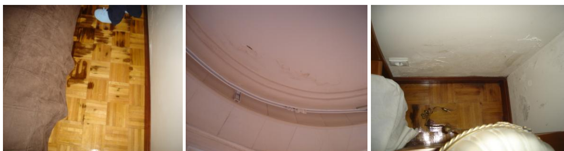
Fig. 50 - Manchas de Humidade no Pavimento em parquet. Descasque de tinta em tecto. Descasque de tinta em parede.
