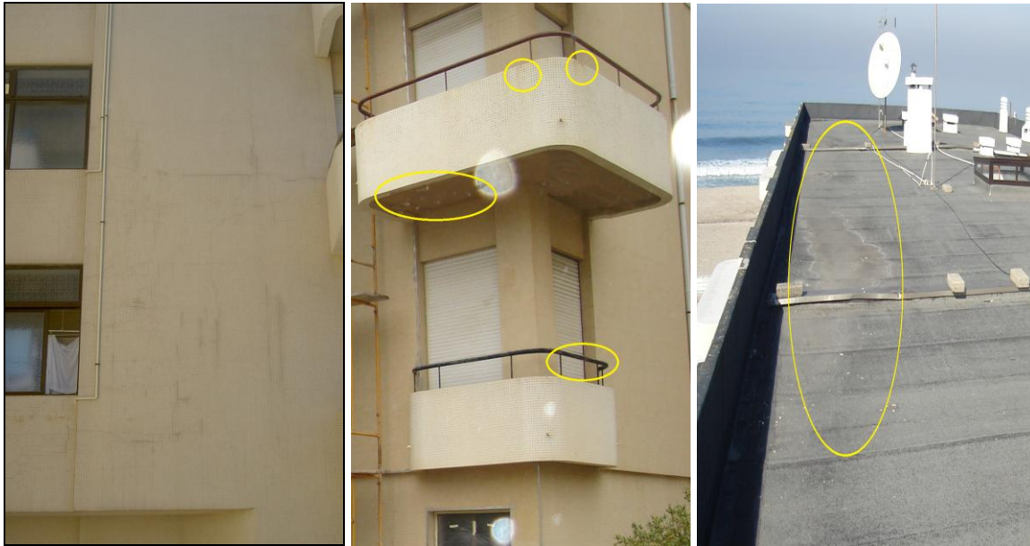
Fig. 34 – Fissuração no revestimento da fachada. Descasque do tecto das varandas e escorrência de ferrugem nos muretes das varandas. Aspecto degradado da impermeabilização da cobertura.
