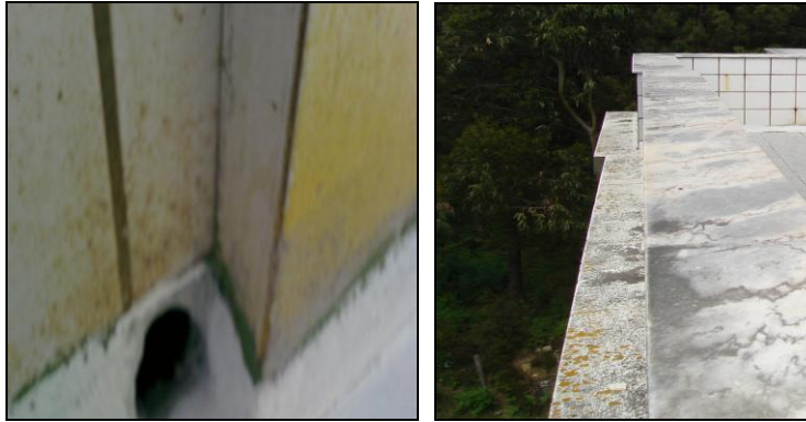
Fig. 40 – Presença de fungos nos muretes do terraço e parapeitos.
