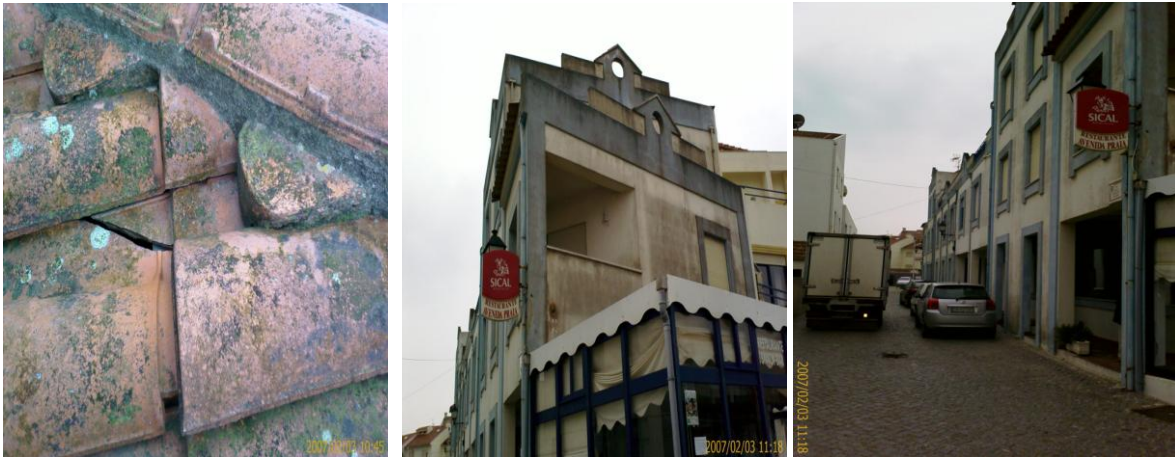
Fig. 53 – Degradação do revestimento da cobertura. Degradação da fachada. Maior degradação da fachada junto ao solo.
