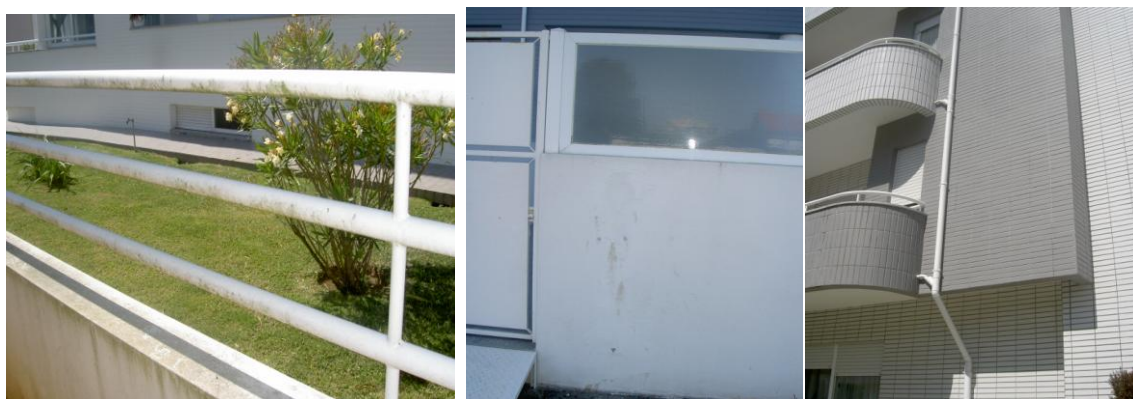
Fig. 51 – Sujidade em varões e muros. Descasque de tina em muros. Aparência da fachada.
