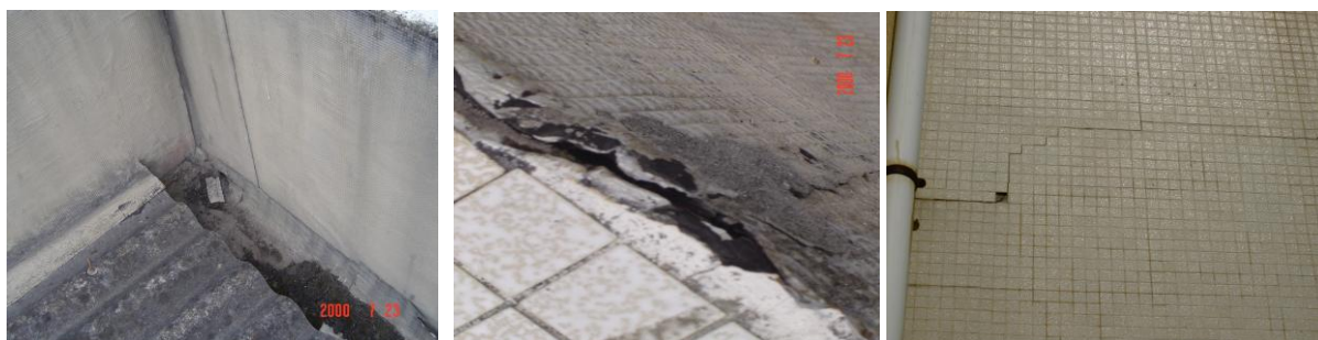
Fig. 58 – Degradação das telhas em fibrocimento. Remate descolado e deficiente entre cobertura e fachada. Fissuração no revestimento em pastilha.
