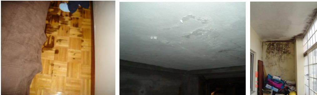
Fig. 64 – Exemplos das Patologias Interiores (pág. 79, 87 e 90)
