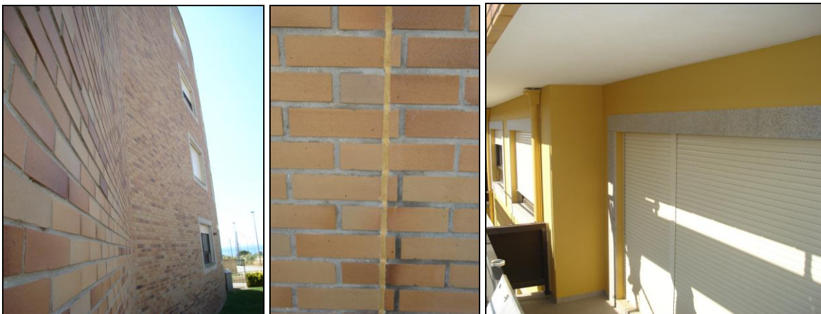
Fig. 32– Fachada Lateral. Junta de Dilatação. Tectos de Varandas.
