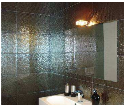
Figura 5.83 - Instalação Sanitária de Serviço
