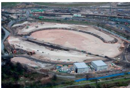
Fig. 32 - Área do estaleiro do Estádio Olímpico contaminada por amianto [54]
