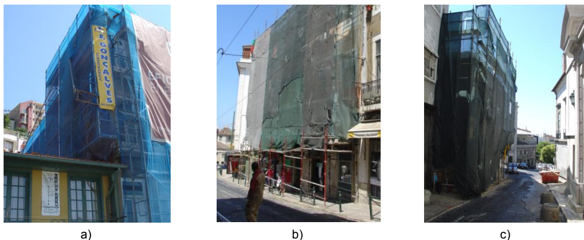
Figura 2.5 - a) Andaime sobre edifício adjacente; b) e c) Espaço de estaleiro reduzido com deposição de contentor para resíduos de construção e de demolição (RCD) em espaço público e ausência de stocks
