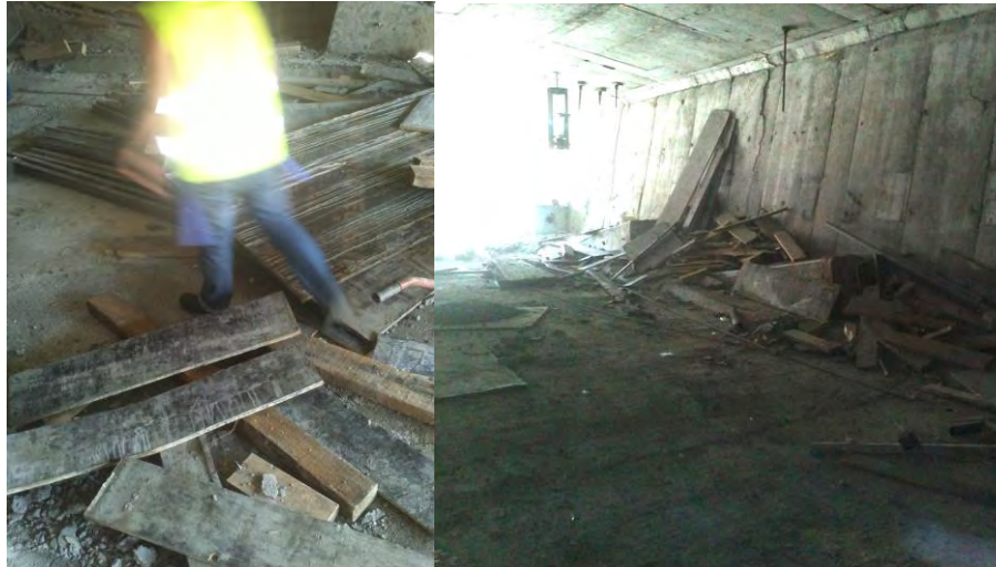
Figura 26 – desorganização no interior da viga caixão
