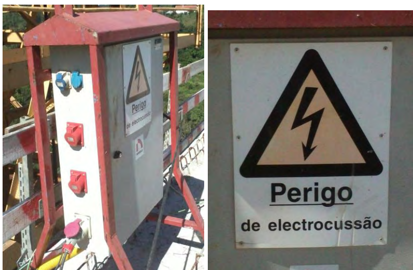
Figura 74 - Pimenteiro com sinal de "Perigo de electrocussão"
