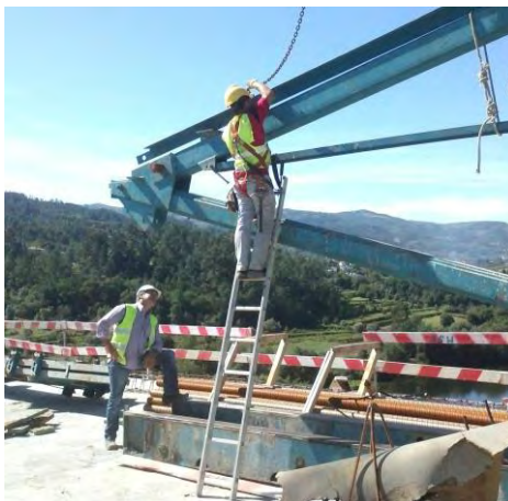
Figura 34 - Trabalhador apoiado em escada de mão devidamente estabilizada
