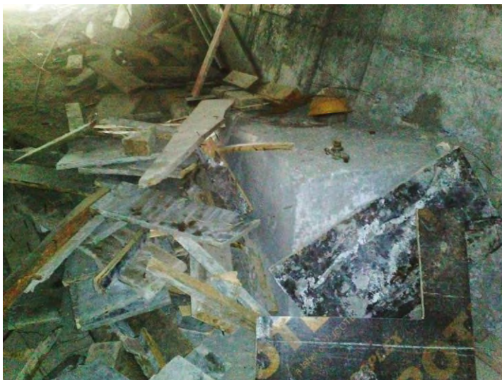
Figura 44 - Sobras de placas de cofragem e madeira
