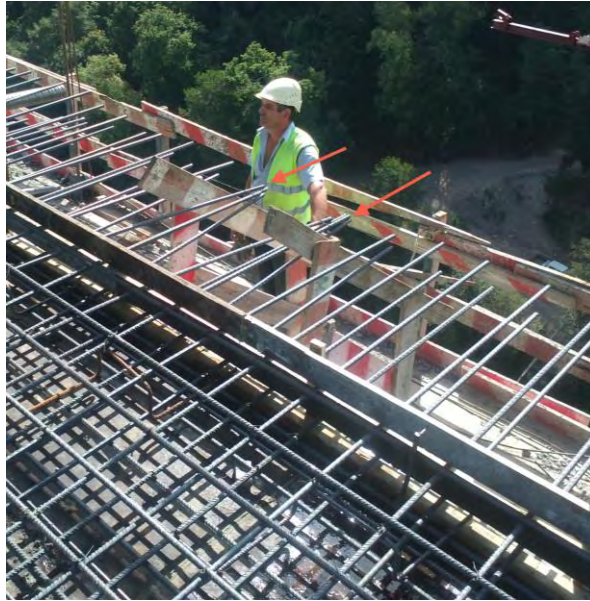
Figura 59 - Ferros de espera sem proteção na zona da escada de acesso
