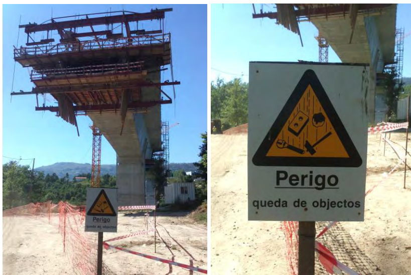
Figura 69 - Zonas delimitadas com devida identificação do perigo
