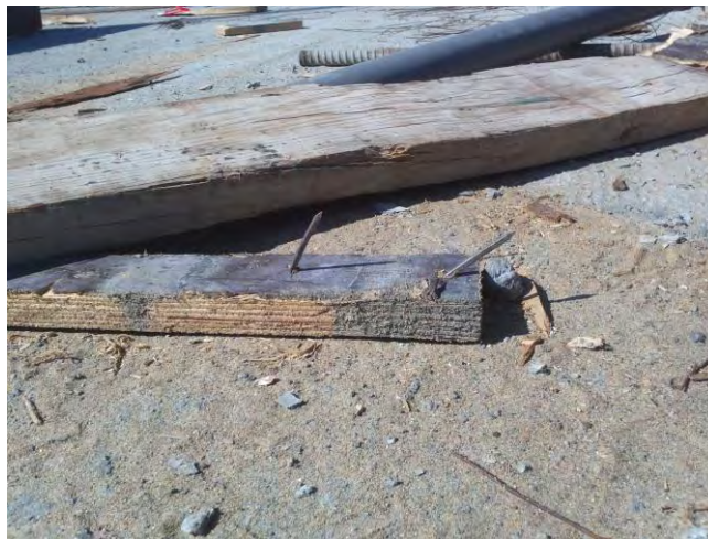
Figura 80 – Má prática observada em obra
