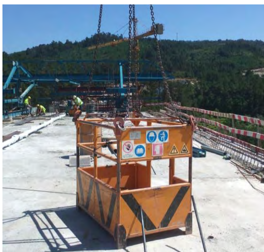
Figura 35 – Plataforma suspensa de elevação de pessoas
