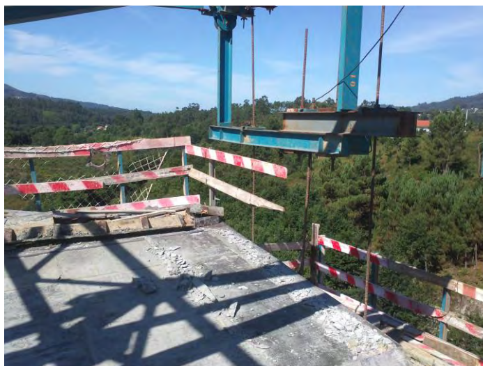
Figura 56 - Periferia da cofragem do tabuleiro munida de guarda-corpos em mau estado de conservação
