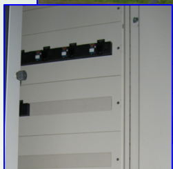
Quadro Geral de Baixa Tensão
