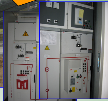
Celas de Média Tensão
