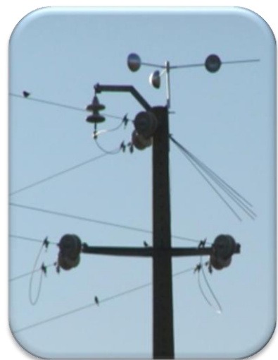
Varetas + Turbina de vento
