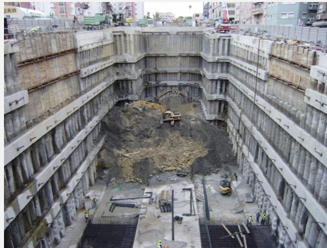
Figura 9 - Contenção de estacas moldadas com 0,60 m de diâmetro afastadas de 1,20 m ancoradas em 5 níveis de vigas de ancoragem na Estação do Metro de Moscavide, Lisboa, 2009
