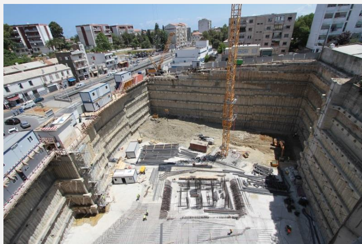
Figura 10 - Contenção de estacas moldadas secantes com 0,60 m de diâmetro ancoradas em 7 níveis na sede do Golf Bank, Argel, 2015
