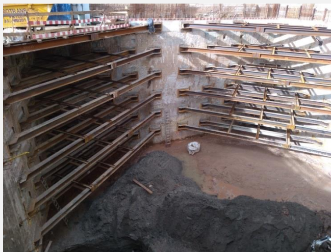
Figura 5 - Contenção com painéis de parede moldada, com espessura de 0,60 m, escorados em 6 níveis em edifício de habitação, na Calçada Marquês de Abrantes, Lisboa, 2018
