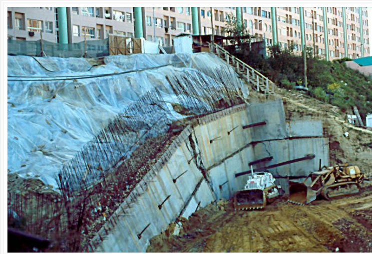
Figura 1 - Colapso de uma parede de contenção tipo Berlim ancorada, na década de 1980, em Lisboa
