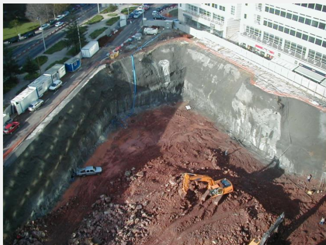
Figura 13 - Contenção com revestimento de betão projetado pregado no Parque de Estacionamento de Miraflores, 2000
