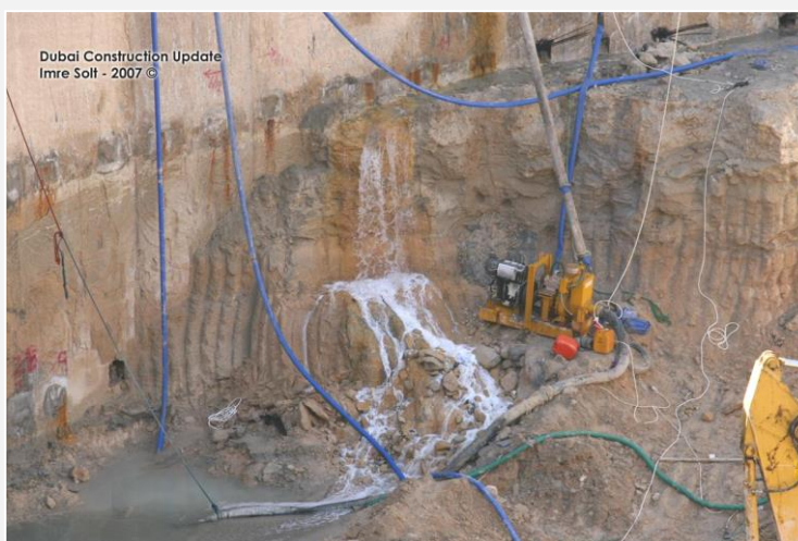
Figura 3 - Afluência de água sob pressão na base de uma contenção tipo Berlim que originou o colapso e inundação total do recinto de escavação
