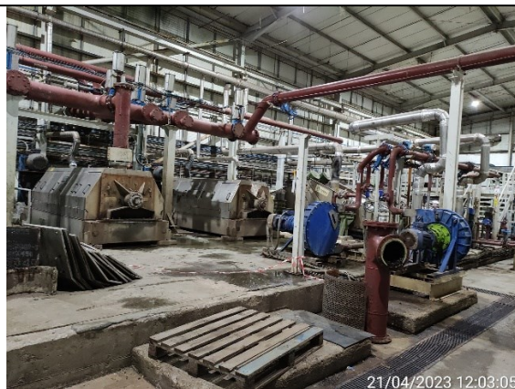
Sistema de alimentação dos digestores e de desidratação do digerido
