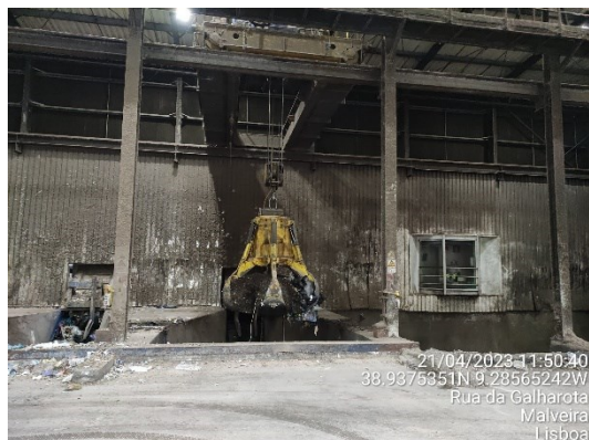
Vista do fosso de descarga dos resíduos e a garra (pólo) que alimenta a tremonha do TMB
