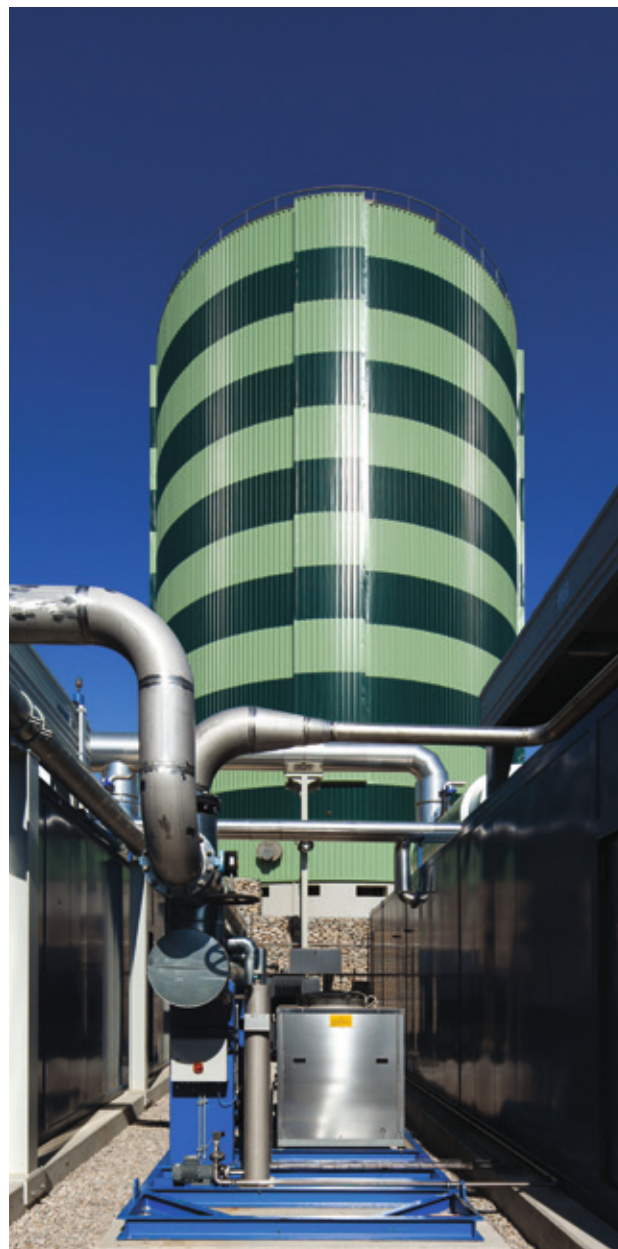
Biodigestor de 3.000 m 3 da digestão anaeróbia da Tratolixo
