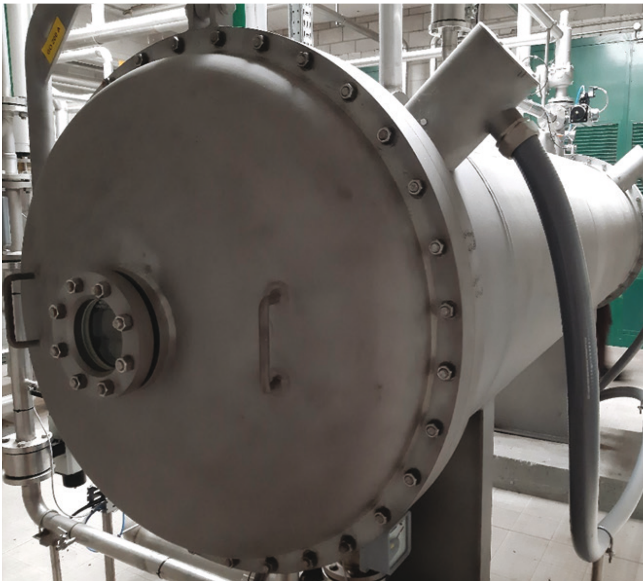
Figura 1 Geradores de ozono numa estação de tratamento de águas residuais
